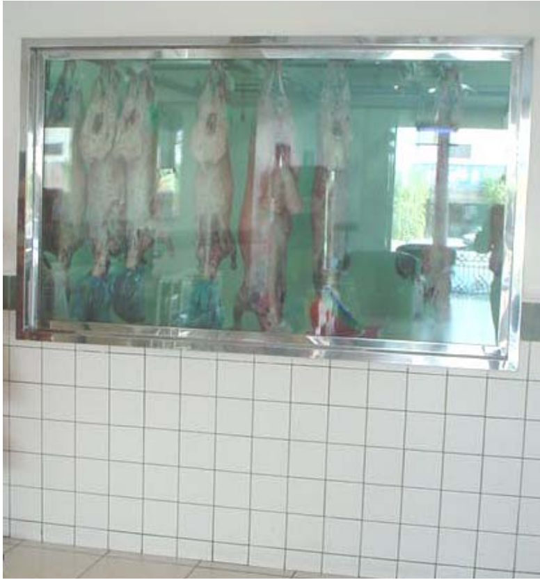
شكل (52) غرف التبريد معزولة بزجاج يوضح ما بداخلها.
